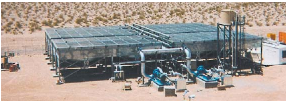
Beispiel Kühltürme in Wüstengegend, Nevada (U.S.A.)
